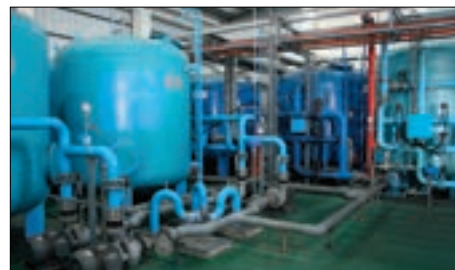
水處理設備 Water treatment
