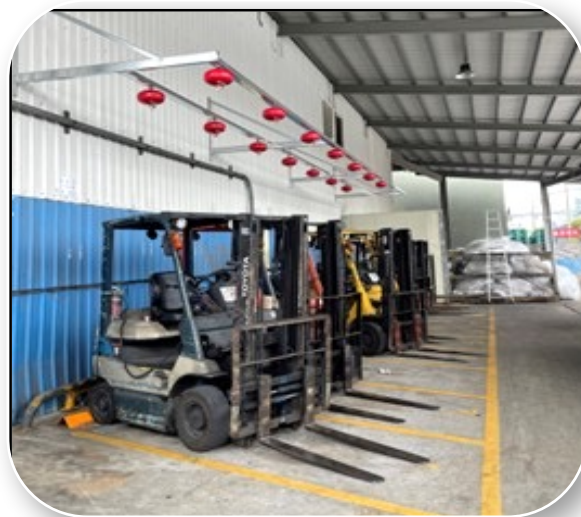
堆高機充電區上方裝懸吊式滅火器
