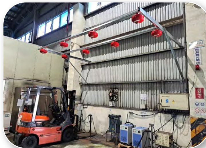
堆高機充電區上方裝懸吊式滅火器
